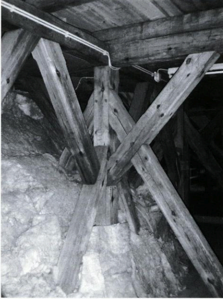
Abb. 8: Stiftskirche Waldsassen. Stehende Stuhlsäule des Vierungstragwerks. Glasfaser-matten verdecken die Kuppeloberfläche. Die Stuhlsäule ist in die Kuppel eingebaut. Photo: Verfasser, März 2003.
