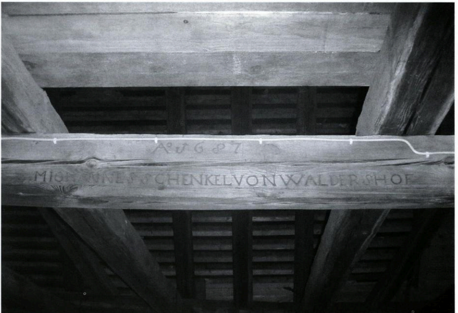
Abb. 9: Stiftskirche Waldsassen. Inschrift: Anno 1687 Johannes Schenkel aus Waldershof an einem Balken im Tragwerk des Konventbaus. Photo: Verfasser, März 2003.
