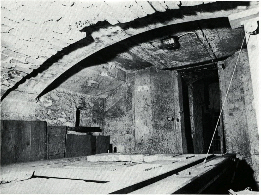
73. Unterirdische Confessio-Anlage unter dem Hochaltar des Domes. Blick nach Osten zur Eingangstüre. Im Vordergrund der Blasebalg der Domorgel
