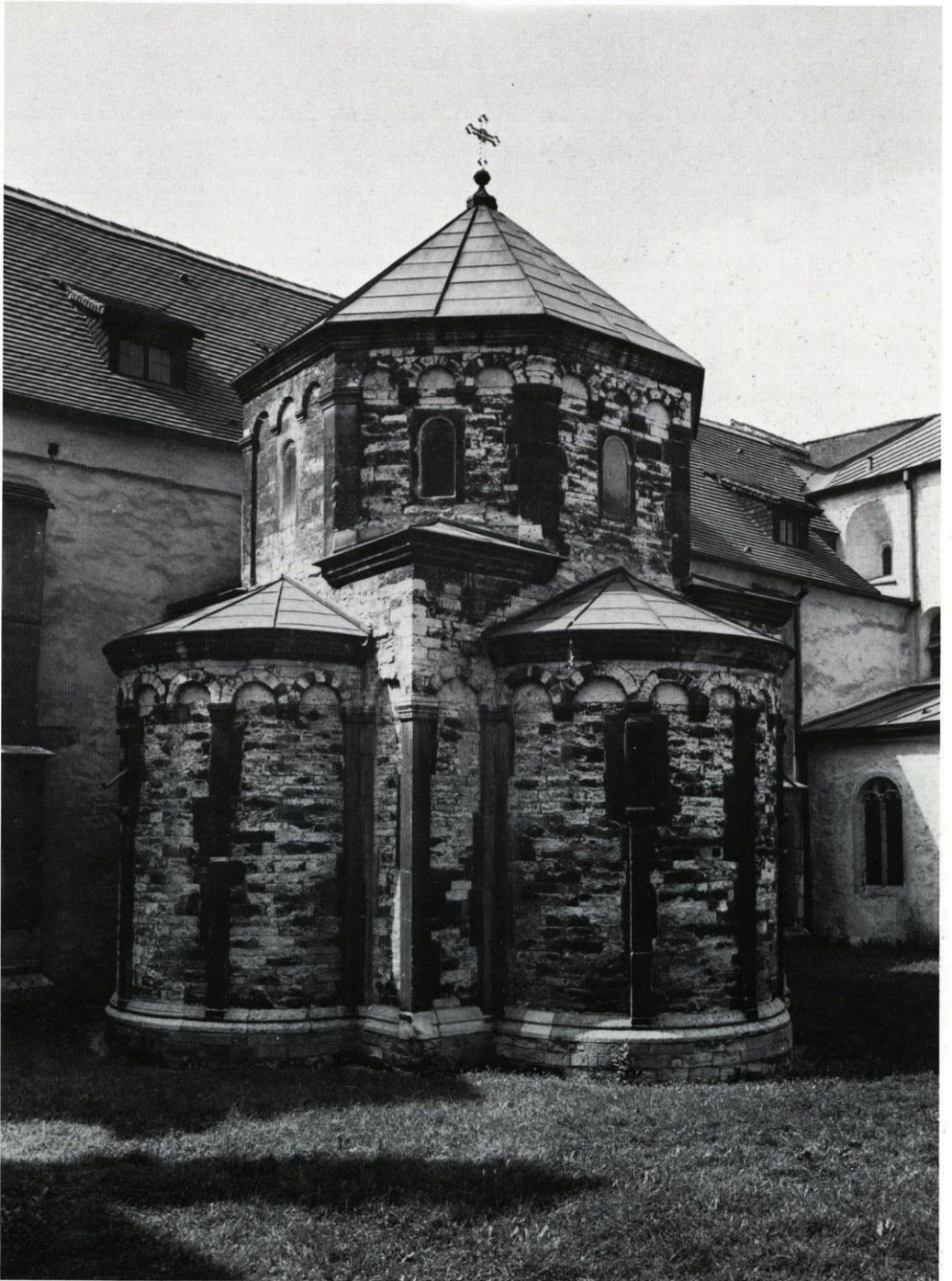
32. Allerheiligenkapelle von außen. Deutlich sichtbar die ständig fortschreitenden Verwitterungsschäden des seit ca. 1870 unverputzten Baus
